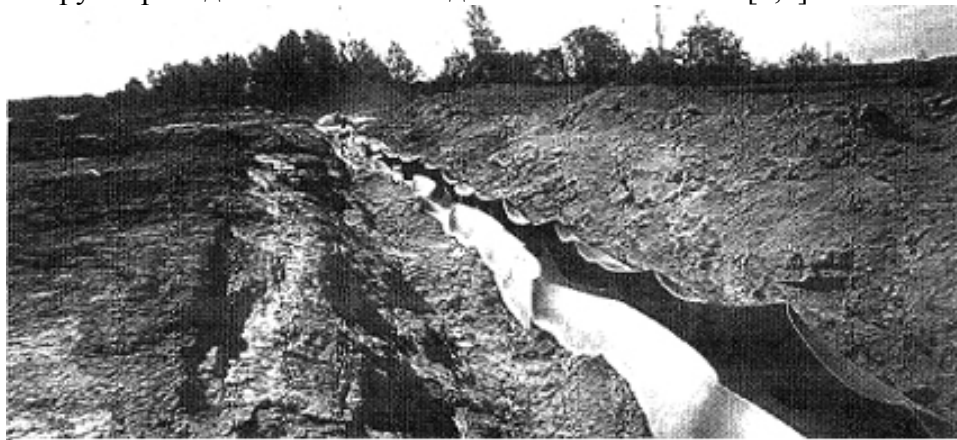
Рис. 2. Аварія на магістральному трубопроводі
